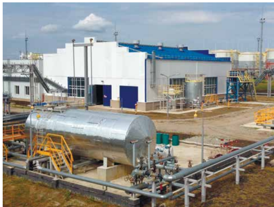
Канализационные очистные сооружения (КОС)
